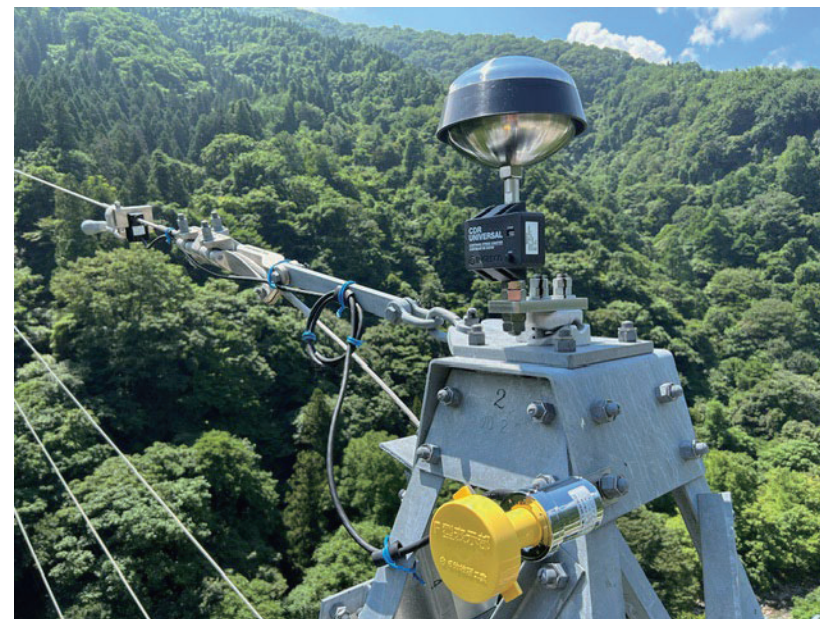
送電鉄塔上部の PDCE-junior。雷サージカウンターと閃絡表示機©も設置
