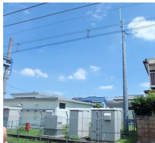
西調布変電所防雷システム
